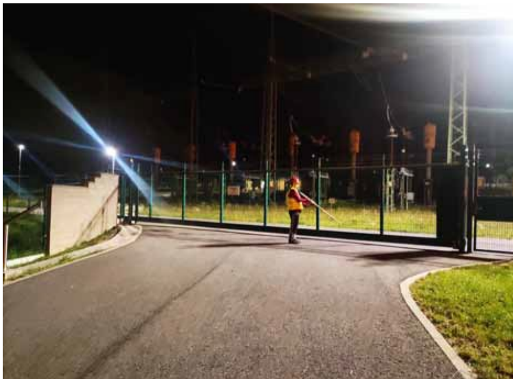
Obr.5 Měření kamerové osvětlenosti vjezdové brány do rozvodny R 245 kV TR Bezděčín
